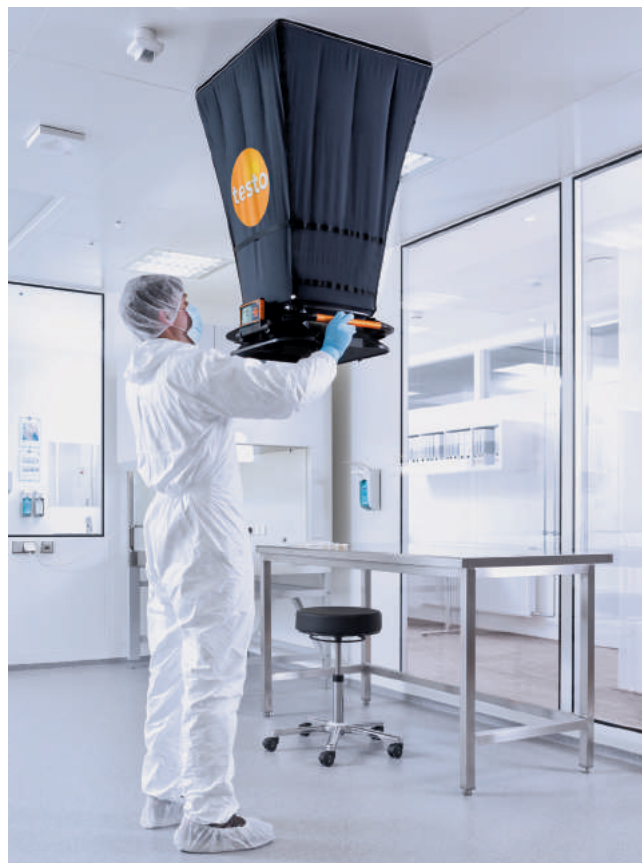
Misura della portata volumetrica con il balometro
