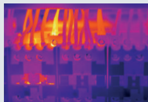
Svolgere la manutenzione degli impianti: rilevare temperature troppo alte dei fusibili o dei componenti elettrici prima che sia troppo tardi.
